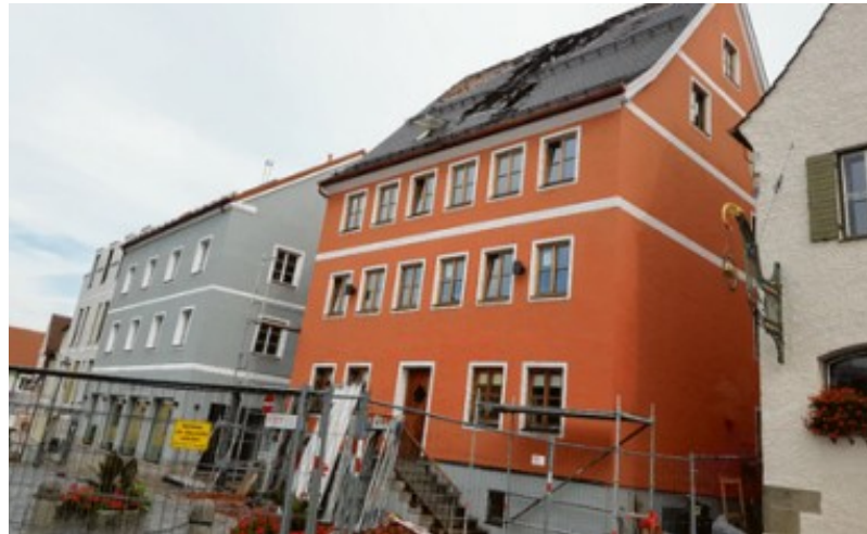
Nach dem Brand ist die Kachelofen-Baustelle abgesperrt, die Sanierungsarbeiten haben begonnen.
